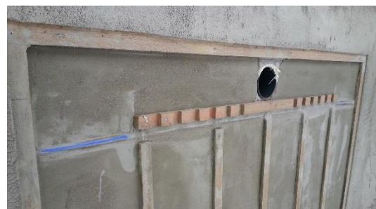
Abbildung 2: Foto der Feldtestfläche der aLT, oberes Ende mit Lufteinlass in den Raum
