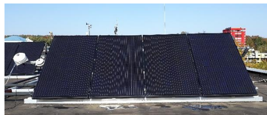
Abbildung 2: Dach des Demonstrators mit einem Teil der PVT-Hybridkollektoren
